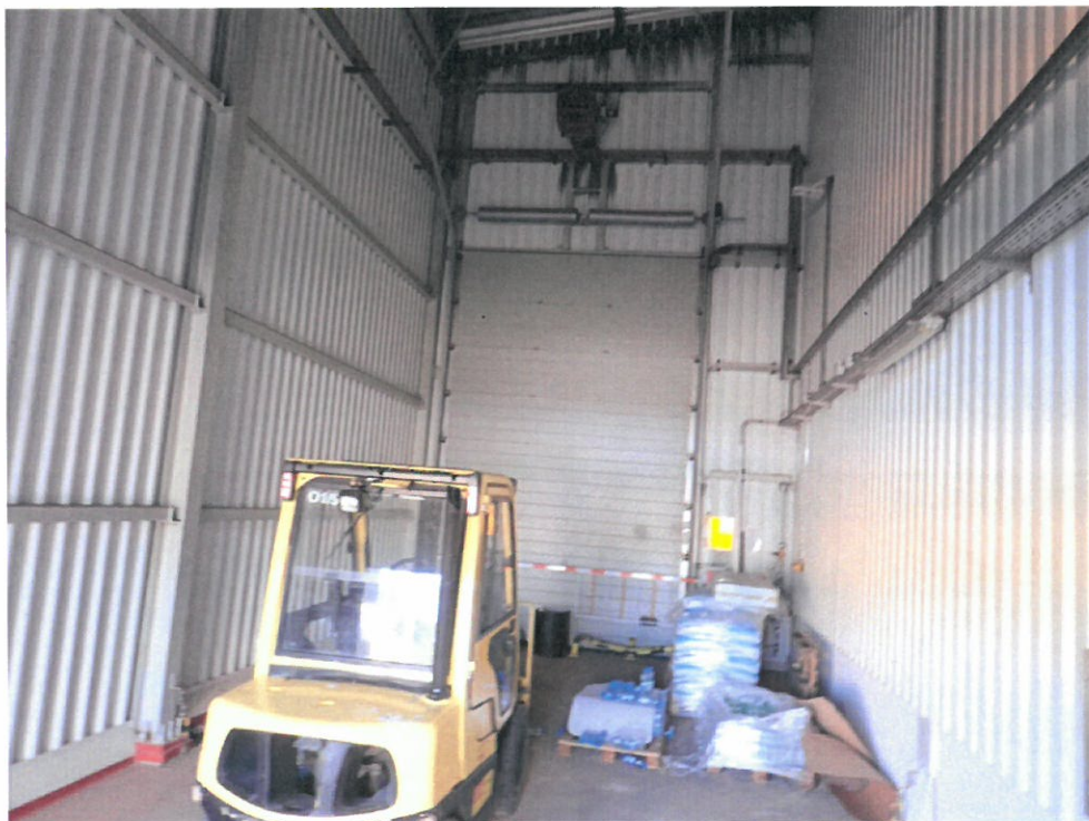
Obiekt S2 – śluza wjazdowa silos skratek (K13_S2)
