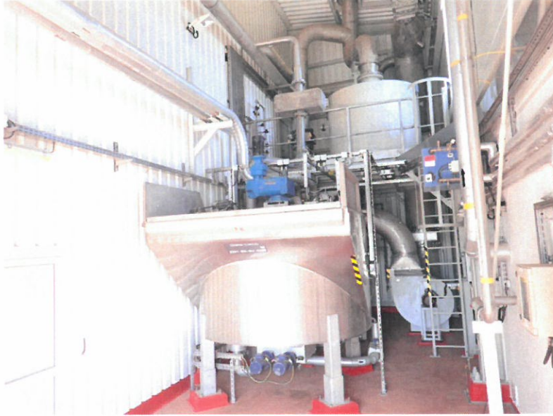
Obiekt S2 – zbiornik tłuszczu (K16_S2)
